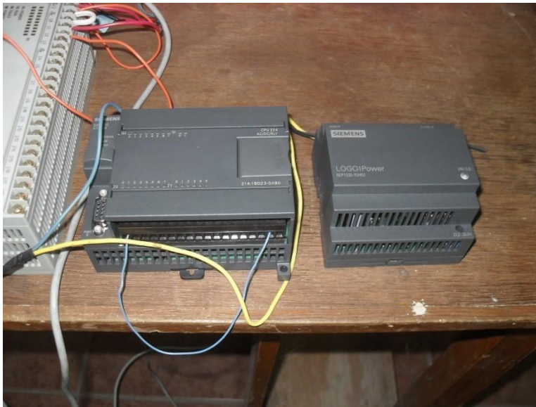
PLC marca SIEMENS. Fuente de Poder y Modulo de Entradas y Salidas
